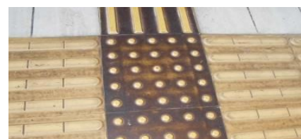
図4 黒く汚れた点字ブロック
